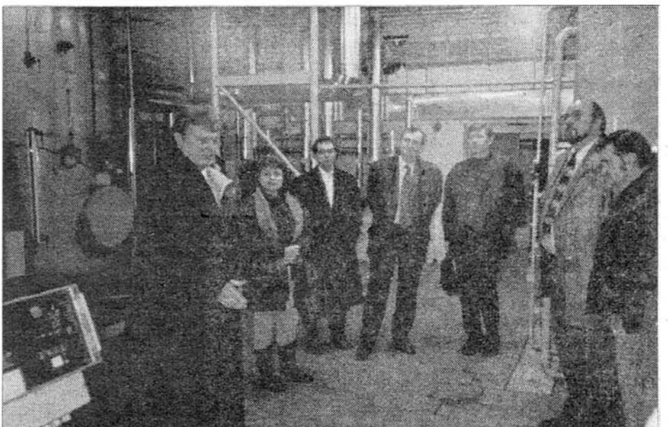
Zastupitelé si prohlížejí moderní technologii naší nové plynové kotelny.
