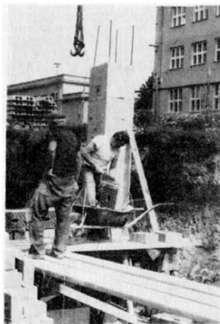
Na snímku Karla Řičánka je zedník Alois Májek z Hodějvic a místopředseda MěstNV Jan Jeřábek jako brigádník při provádění vyzdívek na stavbě polikliniky
