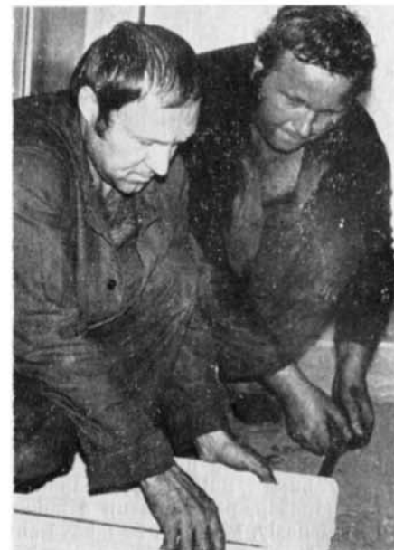
Údržbáři Milan Plotěný a Miloš Procházka při opravě radiátorů ústředního topení v bytě na náměstí Komenkého ve Slavkově.
